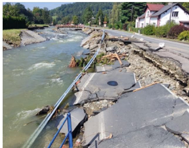
▲ Škody způsobené na Albrechticku.
